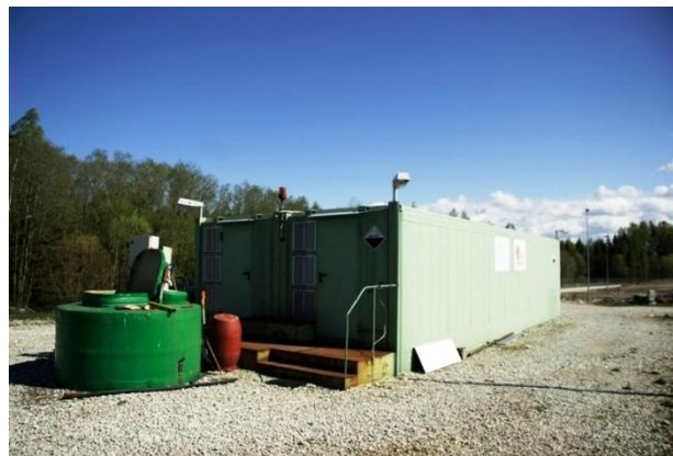
Nõrgvee puhasti ROAW 9141 DT29-09
