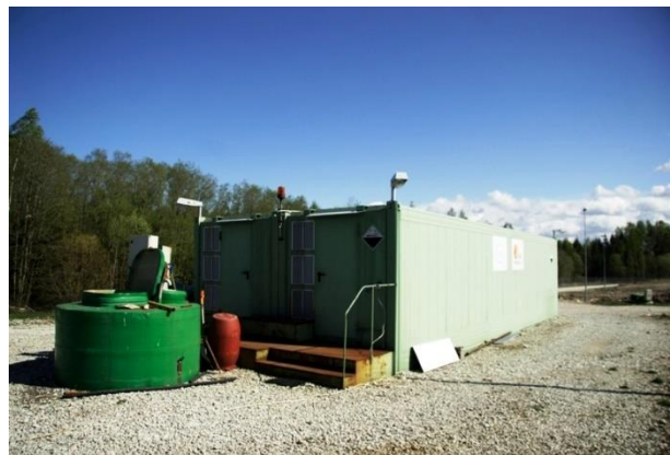
Nõrgvee puhasti ROAW 9141 DT29-09
